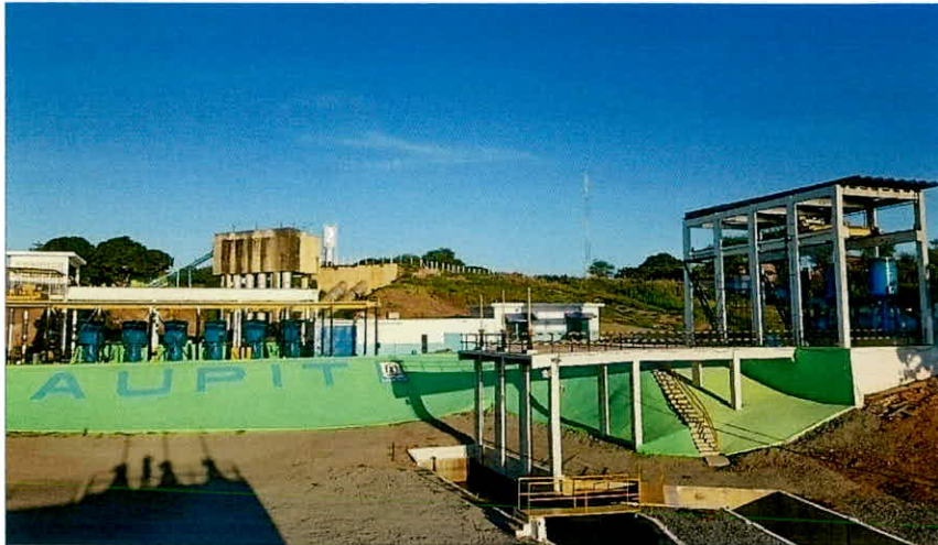
ESTAÇÃO DE BOMBA – EB01
