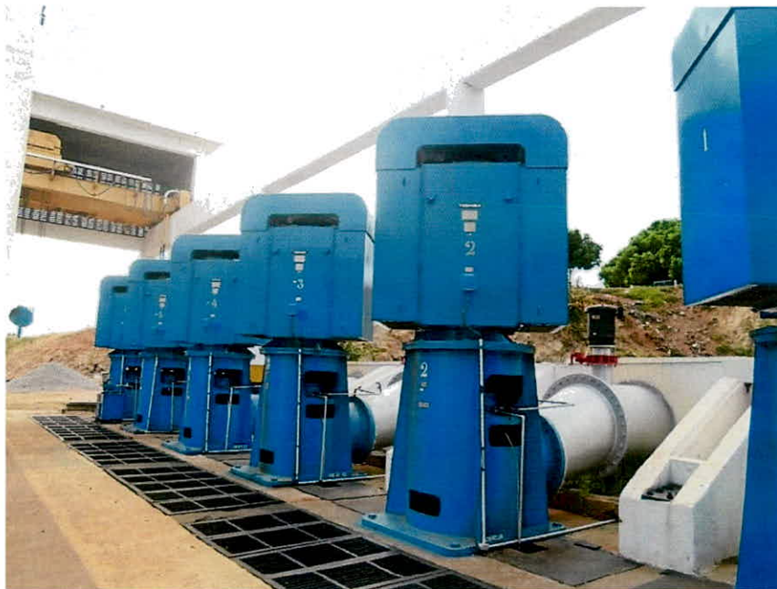
ESTAÇÃO DE BOMBA – EB01
