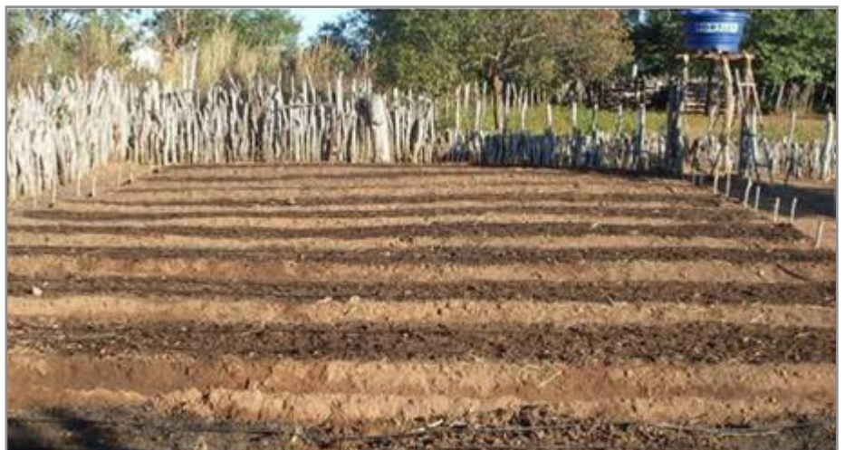
Kit de Irrigação instalado em lote familiar
