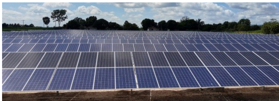
Figura 1 - Usina Fotovoltaica do Projeto Público de irrigação Pirapora Fonte:AUPP, 20221
