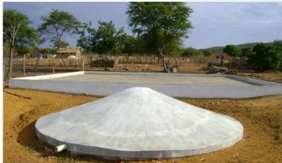
Cisterna calçadão 52 mil litros
