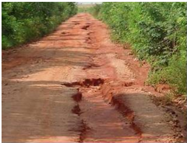
Erosão em estradas
