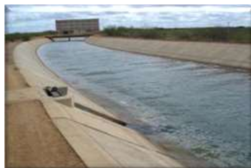
Canal de Perímetro de Irrigação Pontal /PE
