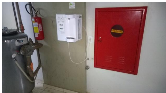
Foto 79: Bebedouro do subsolo instalado acima da altura correta (os registros de água estão a 150cm de altura do piso); Brasília-DF, 22/07/2015.
