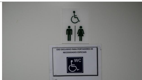
Foto 52: Sinalização do banheiro acessível do 4º andar fora do padrão em relação às cores (figura superior) e com adição de caracteres não devidos (figura inferior); Brasília-DF, 22/07/2015.
