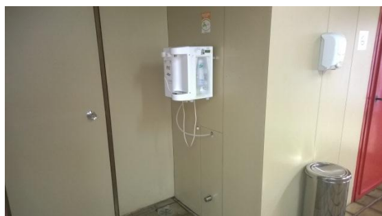
Foto 81: Bebedouro do 1º andar instalado acima da altura correta (os registros de água estão a 150cm de altura do piso); Brasília-DF, 22/07/2015.
