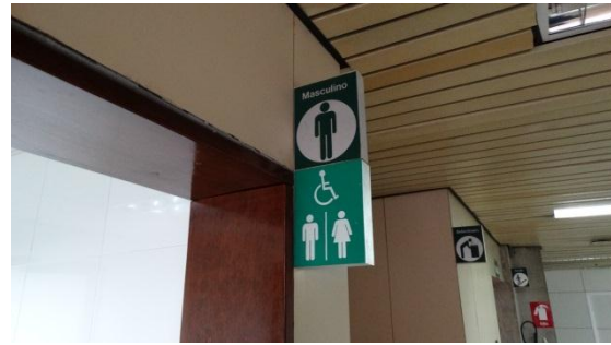
Foto 44: Sinalização do banheiro acessível do 4º andar fora do padrão em relação às cores; Brasília-DF, 22/07/2015.
