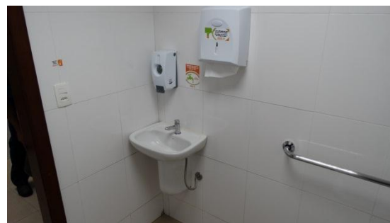
Foto 58: Lavatório do banheiro acessível do 2º andar sem barra de apoio; Brasília-DF, 22/07/2015.
