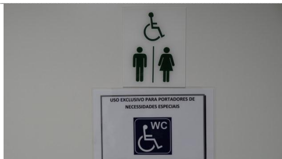
Foto 51: Sinalização do banheiro acessível do 3º andar fora do padrão em relação às cores (figura superior) e com adição de caracteres não devidos (figura inferior); Brasília-DF, 22/07/2015.
