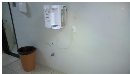
Foto 80: Bebedouro do subsolo instalado acima da altura correta (os registros de água estão a 150cm de altura do piso); Brasília-DF, 22/07/2015.
