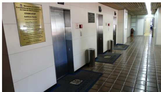
Foto 16: Hall dos elevadores do 1º andar sem sinalização tátil de alerta no piso, sem piso tátil direcional e com piso trepidante; Brasília-DF, 22/07/2015.
