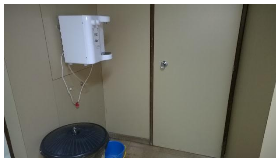
Foto 84: Bebedouro do 2º andar instalado acima da altura correta (os registros de água estão a 150cm de altura do piso); Brasília-DF, 22/07/2015.
