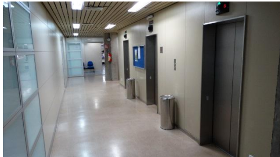
Foto 33: Hall dos elevadores do 3º andar sem sinalização tátil de alerta no piso e sem piso tátil direcional; Brasília-DF, 22/07/2015.
