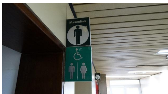
Foto 41: Sinalização do banheiro acessível do 1º andar fora do padrão em relação às cores; Brasília-DF, 22/07/2015.
