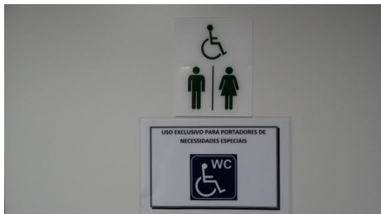
Foto 49: Sinalização do banheiro acessível do 1º andar fora do padrão em relação às cores (figura superior) e com adição de caracteres não devidos (figura inferior); Brasília-DF, 22/07/2015.
