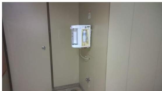
Foto 83: Bebedouro do 2º andar instalado acima da altura correta (os registros de água estão a 150cm de altura do piso); Brasília-DF, 22/07/2015.
