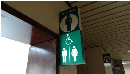
Foto 43: Sinalização do banheiro acessível do 3º andar fora do padrão em relação às cores; Brasília-DF, 22/07/2015.
