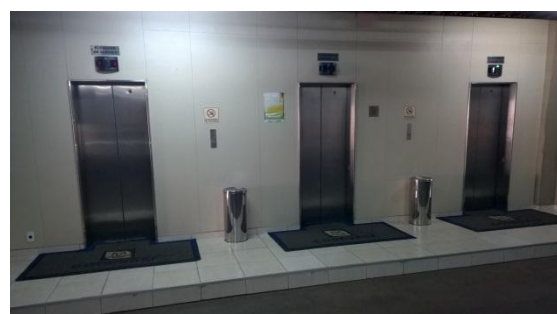
Foto 14: Elevadores do subsolo sem sinalização tátil de alerta no piso e com capachos não embutidos no piso; Brasília-DF, 22/07/2015.
