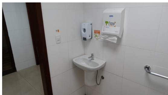
Foto 57: Lavatório do banheiro acessível do 1º andar sem barra de apoio; Brasília-DF, 22/07/2015.
