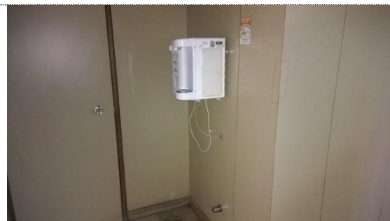
Foto 85: Bebedouro do 3º andar instalado acima da altura correta (os registros de água estão a 153cm de altura do piso); Brasília-DF, 22/07/2015.
