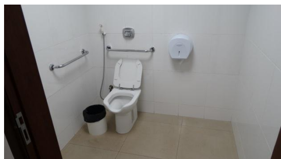
Foto 56: Interior do banheiro acessível do 4º andar: barras de apoio com diâmetro de 2,5cm, comprimento de 60cm e altura em relação ao piso de 90cm (medidos do eixo de fixação); a distância medida entre o eixo da bacia e a face da barra lateral ao vaso é de 42cm; a distância medida entre a borda frontal da bacia e a projeção do 1º ponto de fixação da barra lateral é de 20cm; a distância medida entre o 2º ponto de fixação da barra lateral e a parede do fundo é de 19cm; papeleira instalada a 95cm do piso e na parede errada; ausência de cabide, de porta-objetos e de puxador horizontal do tipo gaveta junto às dobradiças no lado interior da porta; Brasília-DF, 22/07/2015.
