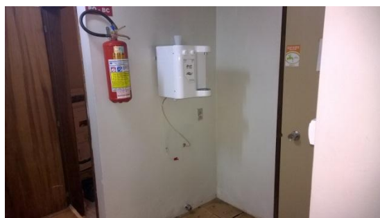
Foto 82: Bebedouro do 1º andar instalado acima da altura correta (os registros de água estão a 150cm de altura do piso); Brasília-DF, 22/07/2015.
