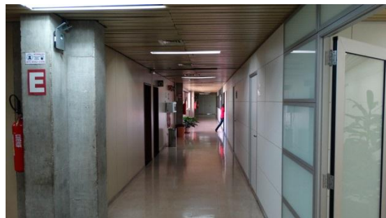
Foto 38: Corredor de circulação do 4º andar sem piso tátil direcional; Brasília-DF, 22/07/2015.
