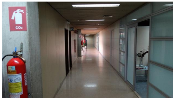
Foto 35: Corredor de circulação do 3º andar sem piso tátil direcional; Brasília-DF, 22/07/2015.
