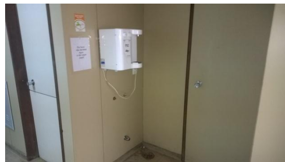
Foto 87: Bebedouro do 4º andar instalado acima da altura correta (os registros de água estão a 160cm de altura do piso); Brasília-DF, 22/07/2015.
